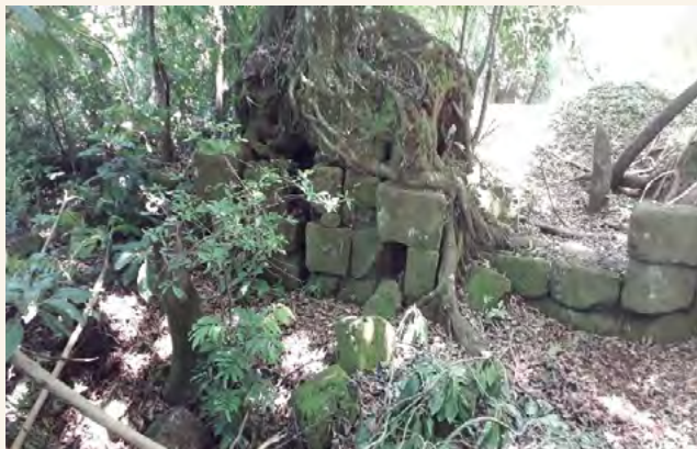
Estado de conservação de uma das paredes do Pátio dos Padres, entre a Igreja e a Varanda de acesso à Quinta
